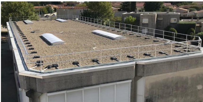
Collège Isclo d'Or 3000m 2 Conseil Départemental de la Drôme TERRASSE INACCESSIBLE GRAVILLON
